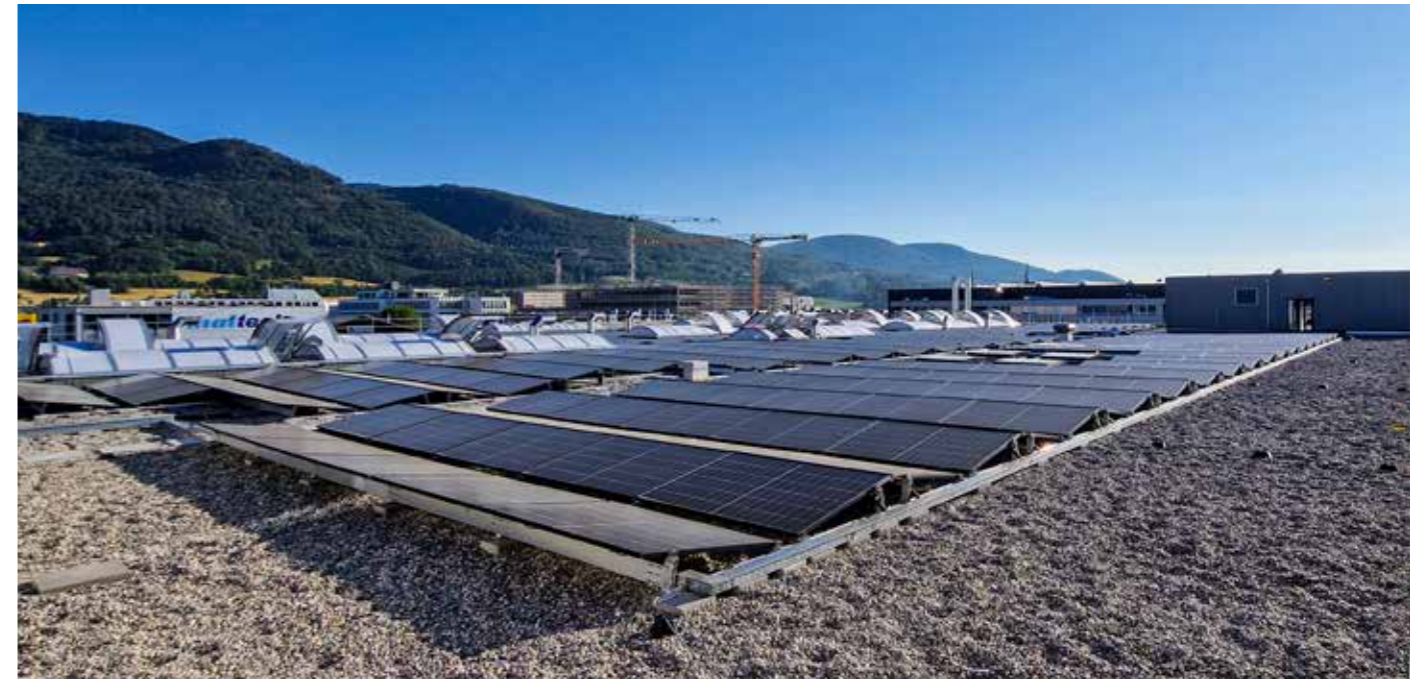
Der neueste Schwob AG Standort in Härkingen wird mit Hilfe einer Photovoltaikanlage mit Energie versorgt.
